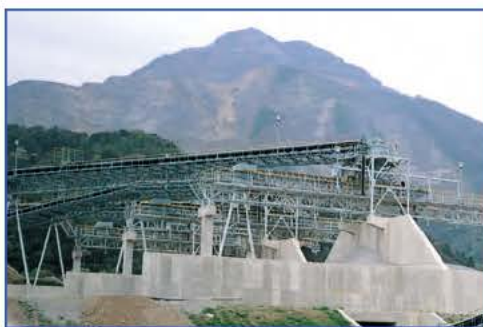
砕石搬送ベルトコンベア設備
