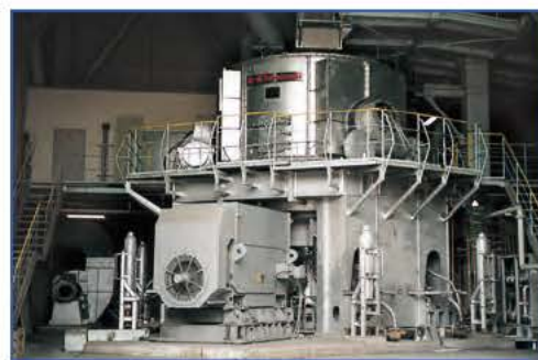
クリンカー予備粉碎設備
