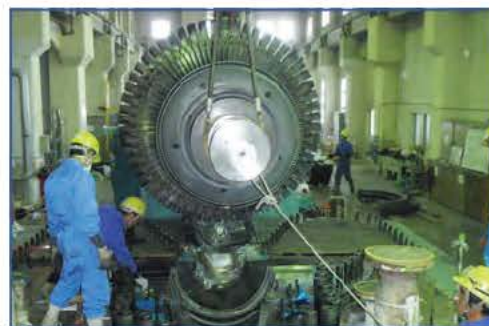
発電用タービン設備
