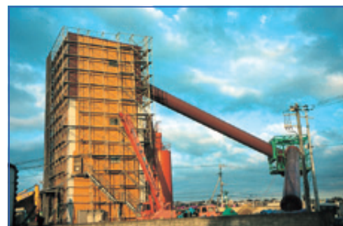
生コンプラント設備
